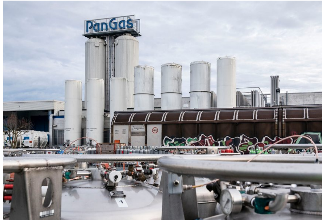
In den grössten Tanks wird ein CO 2 -Gemisch unter 20 Bar Druck gelagert: Das Werk in Dagmersellen LU.
